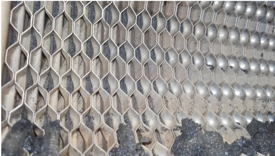
Abbildung 16 - Dichtungsauflösung aufgrund zu aggressiver Reinigungsmittel
